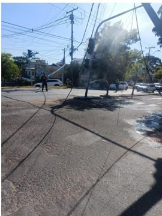
Incendio de pequeña Magnitud de un semáforo, ocurrido en fecha 08/06/24.
